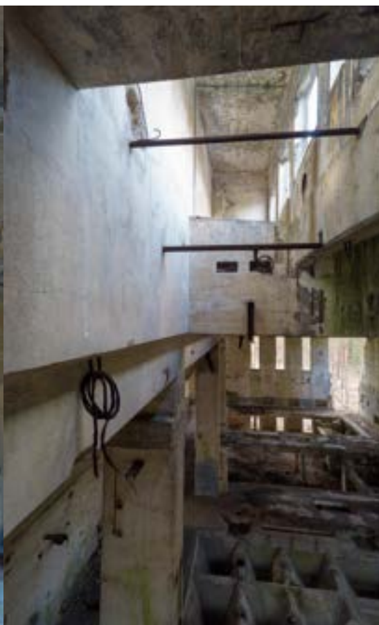
Fot. 26. Nisza pod dachem elektrociepłowni fabryki nr I widziana kamerą drona Źródło: zbiory własne.
