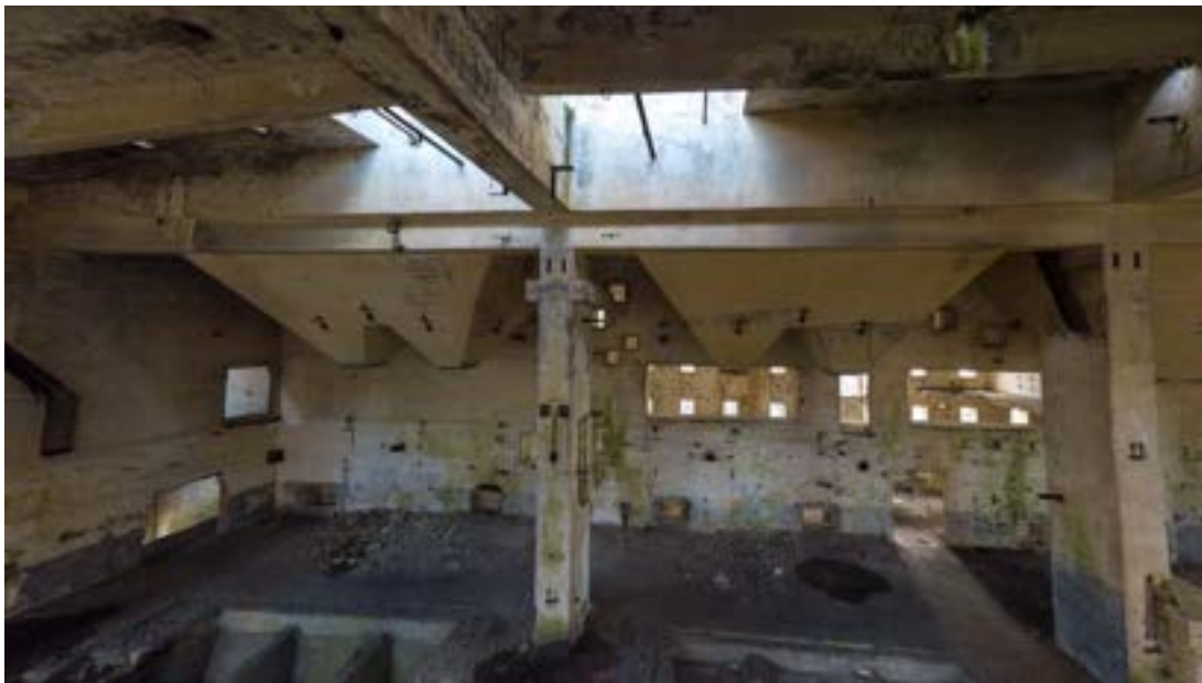
Fot. 20. Ściana dzieląca dwie, sąsiadujące hale elektrociepłowni fabryki nr I, widziana kamerą drona Źródło: zbiory własne.
